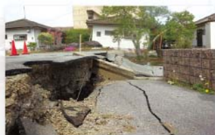
地割れて大きな段差が出来た道路
